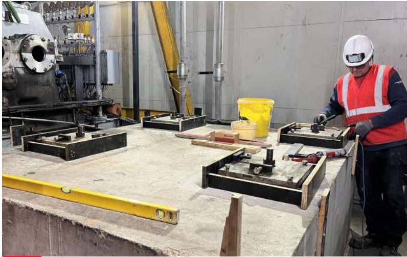
Dépose et repose, avec nivellement haute précision, de platines recevant un alternateur, Noidans-le-Ferroux
